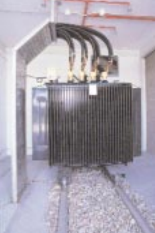
Sala de trafos
