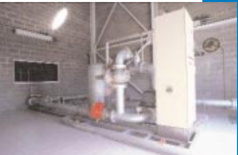
Estación receptora de gas
