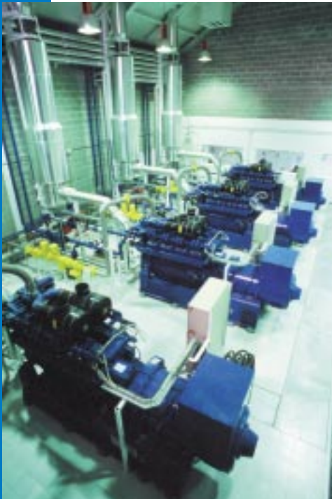
Sala de motores
