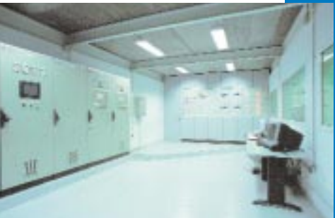
Sala de control y sinóptico
